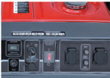
Счётчик времени, средства управления двигателем и автоматический выключатель расположены на рабочей панели.
