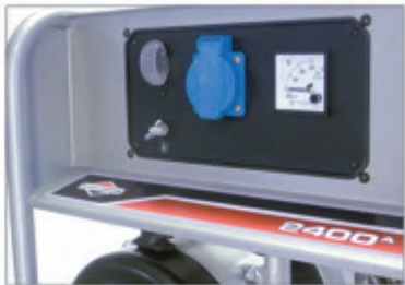
На рабочей панели расположены вольтметр, 1 розетка и выключатель.
